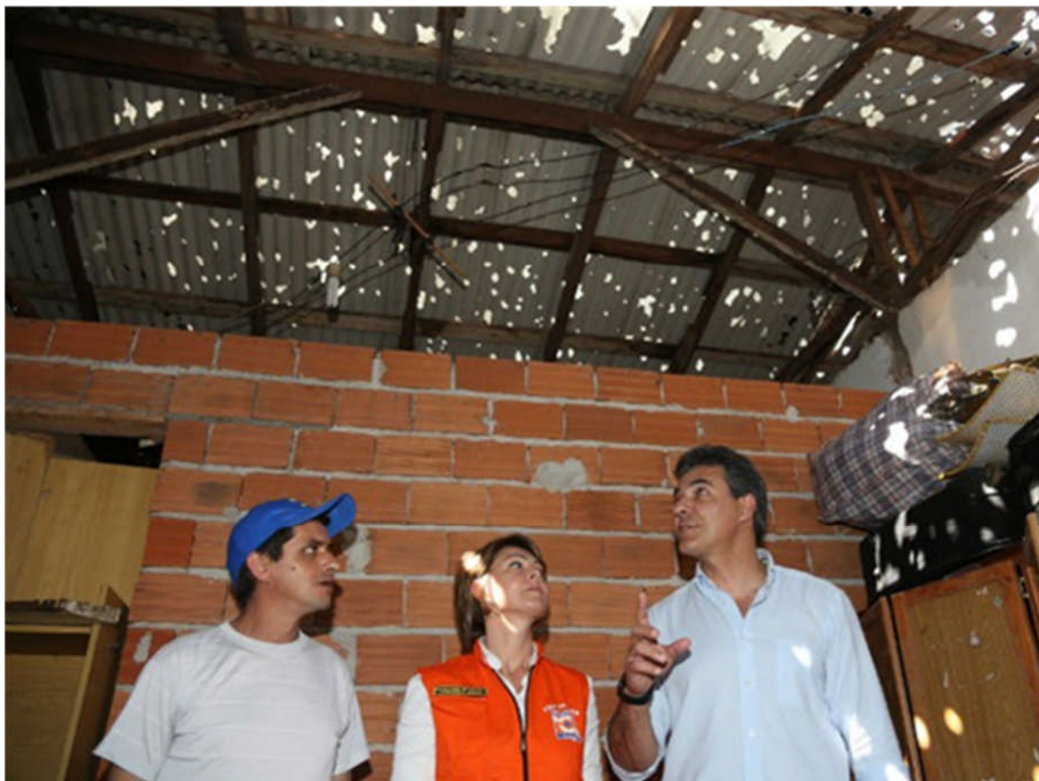
Figura 18. Ejemplos de daños y medidas de recuperación, Porto Meira, Foz do Iguaçu.
